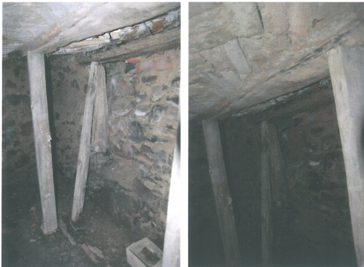
Fot. 7 Uszkodzona ściana piwniczna oraz strop
