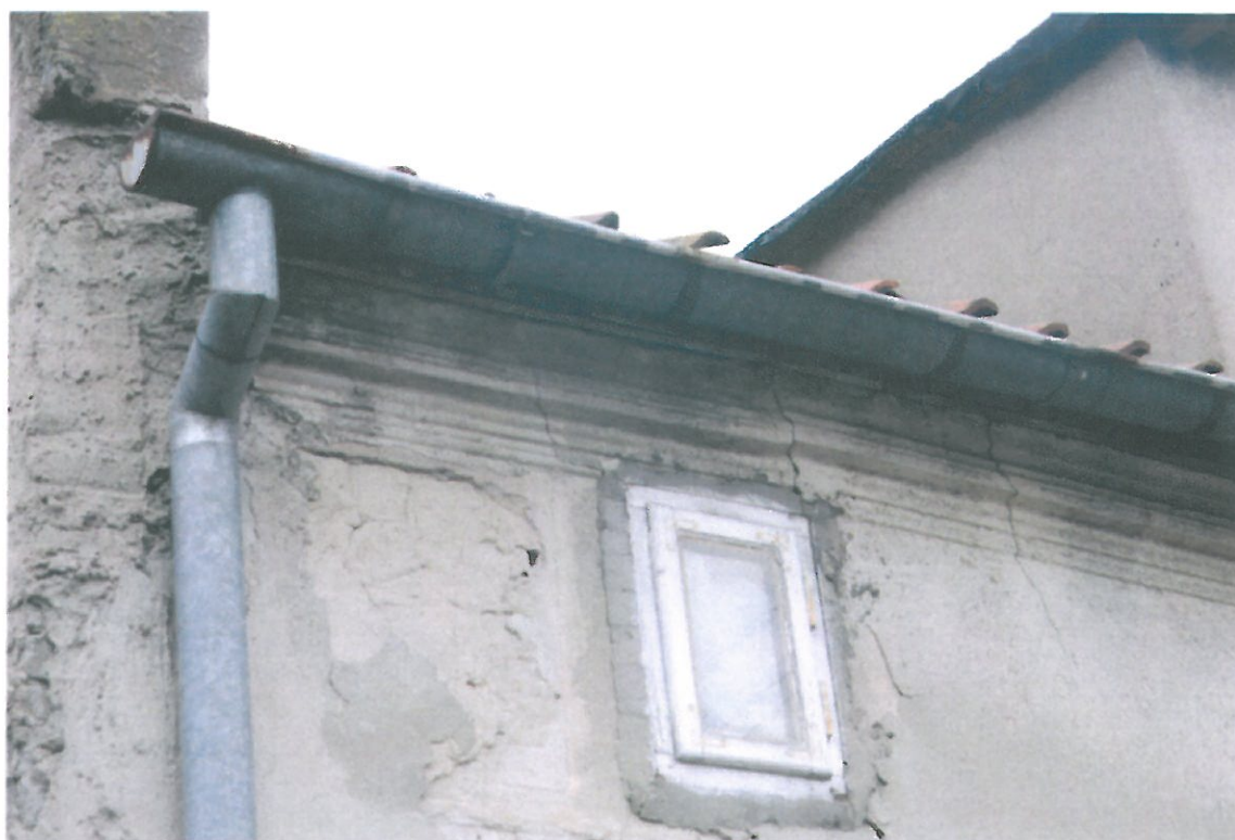
Fot. 4 Pęknięcia gzymsów okapowych od strony podwórka
