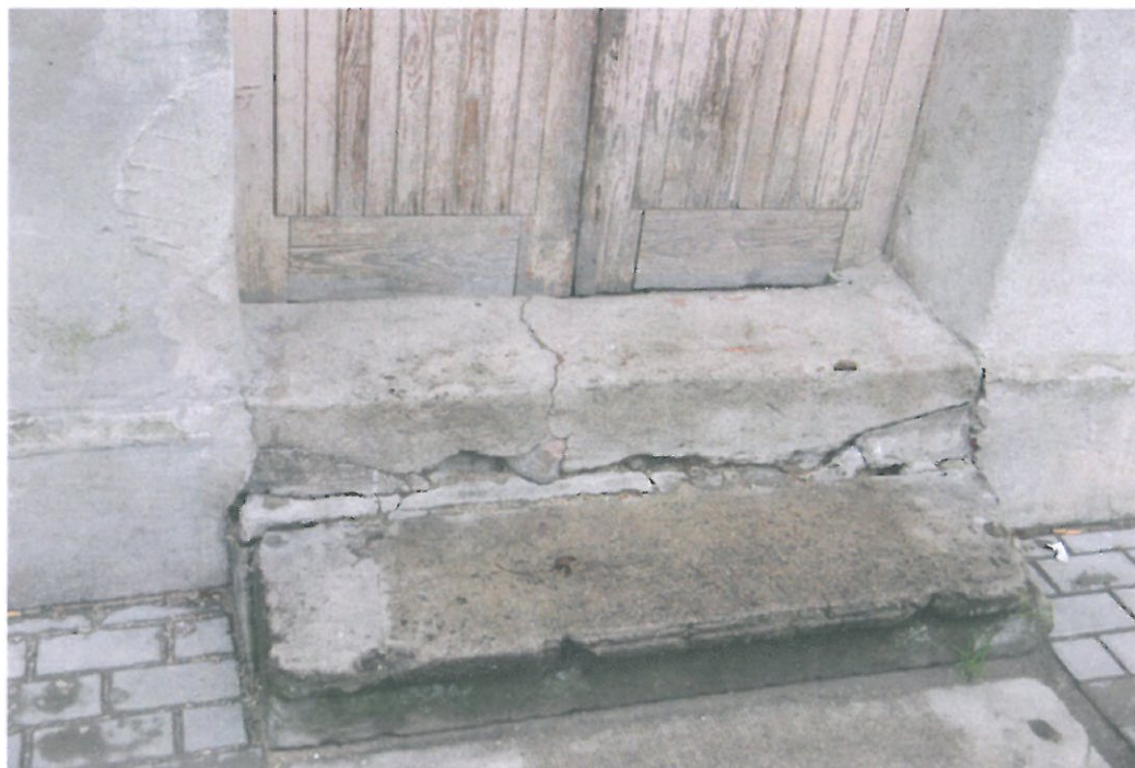
Fot. 8 Schody wymagające naprawy
