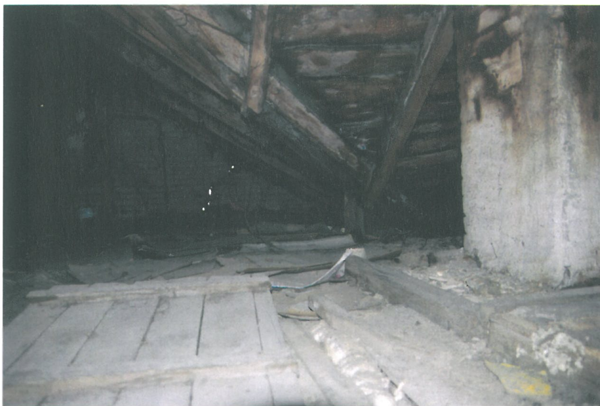
Fot. 6 Widok skorodowanego deskowania oraz komina do przemurowania
