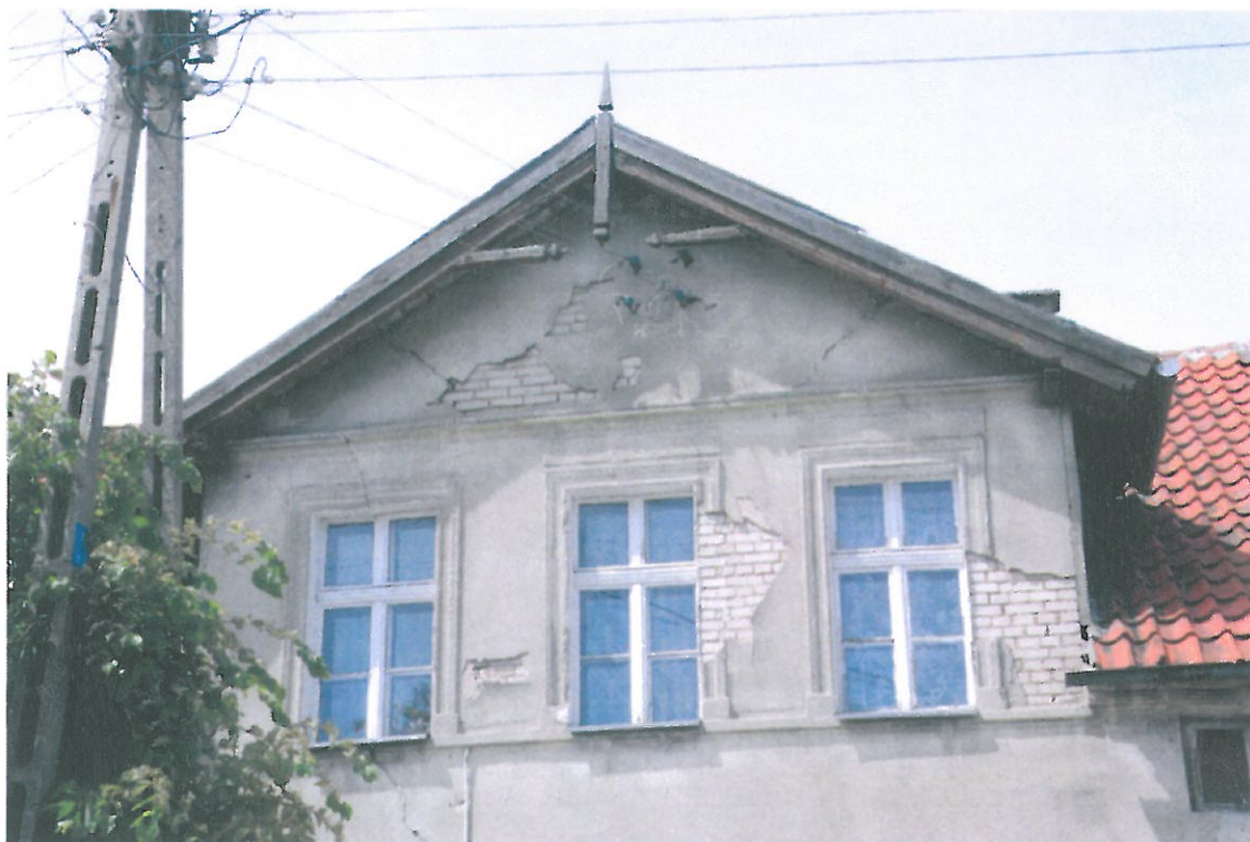
Fot. 5 Pęknięcia ścian na lukamie frontowej
