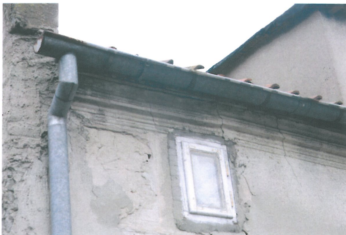
Fot. 4 Pęknięcia gzymsów okapowych od strony podwórka
