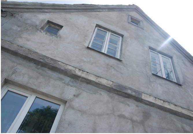
Fot. 1 Gzymsy podlegające odtworzeniu
