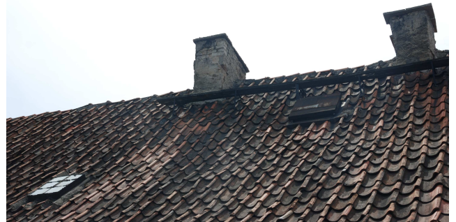
Fot. 4 Widok zapadniętego dachu
