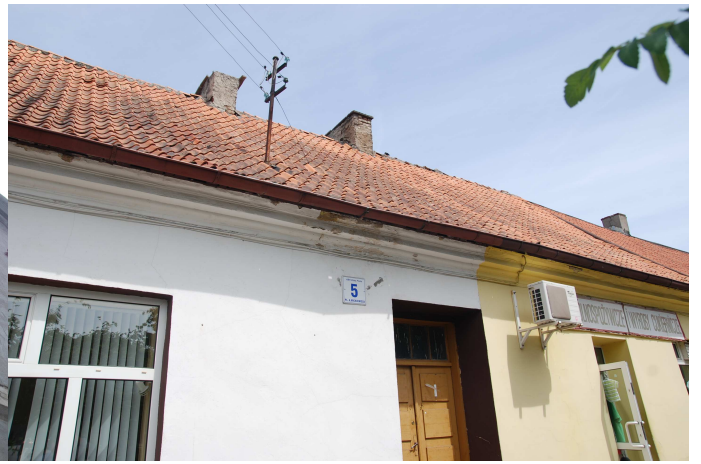
Fot. 2. Gzymsy podlegające wyrównaniu zaprawami
