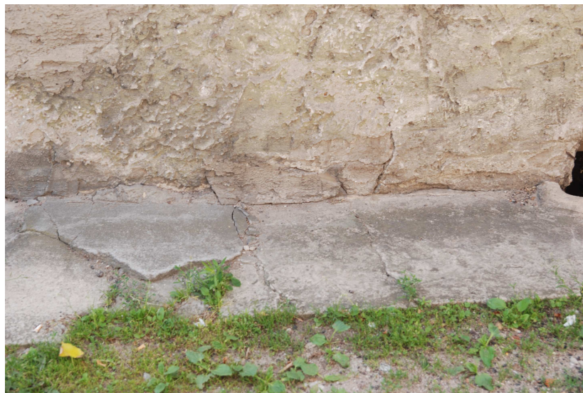
Fot. 5 Opaska betonowa budynku podlegająca wymianie
