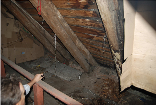
Fot. 3 Widok skorodowanego deskowania
